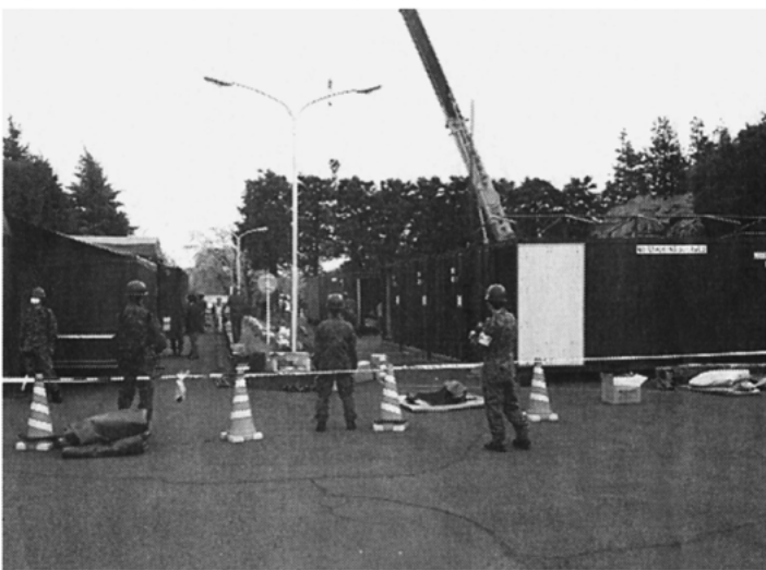
被災した自衛隊仙台病院では一部機能が失われたため、それを補填する目的で新型移動式医療システムの一部が病院駐車場に展開された。写真は展開中の新システム。手術室、手術前室、滅菌室、外来診療室、検査室、薬剤/衛生資材、給排水、電源等の各コンテナおよび移動式CT車などから構成されており、寒冷地や熱帯地においても活動できるよう設計されている
