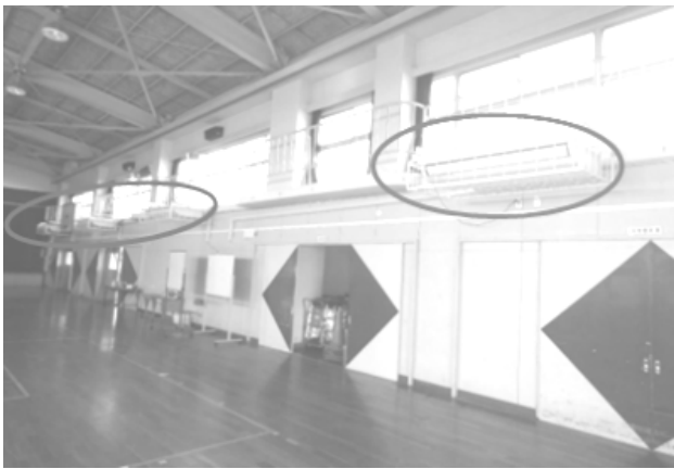
→ 今年度設置された特別支援学校の例 ○囲みが室内機対面にも設置
