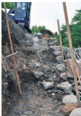
崩壊部石垣断面
