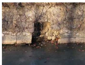
石垣崩落箇所②（近景）
