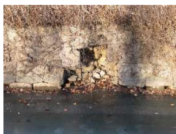
石垣崩落箇所①（近景）
