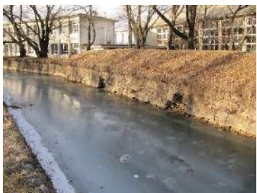
石垣崩落箇所（遠景）
