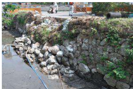
石垣崩壊状況
