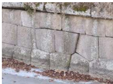
石垣の孕み事例①
