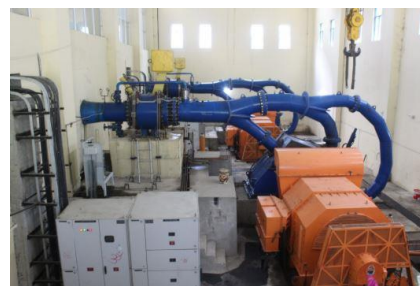
建屋の中の発電機 (Web より)
