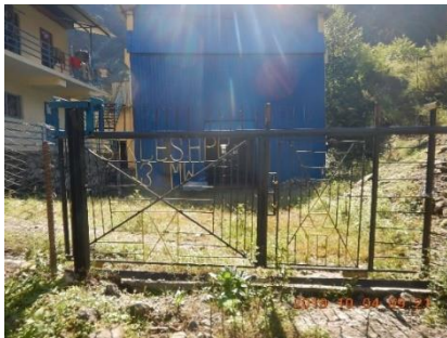
ゲートに「13MW SIKLES HPP」銘
