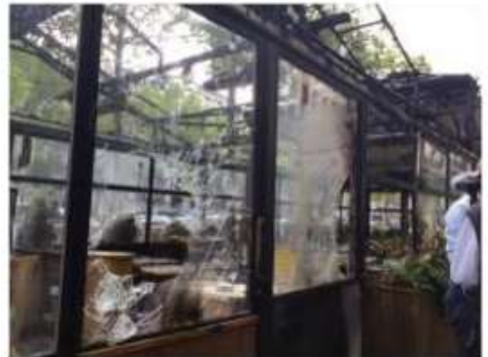
事務所下の放火されたカフェ
