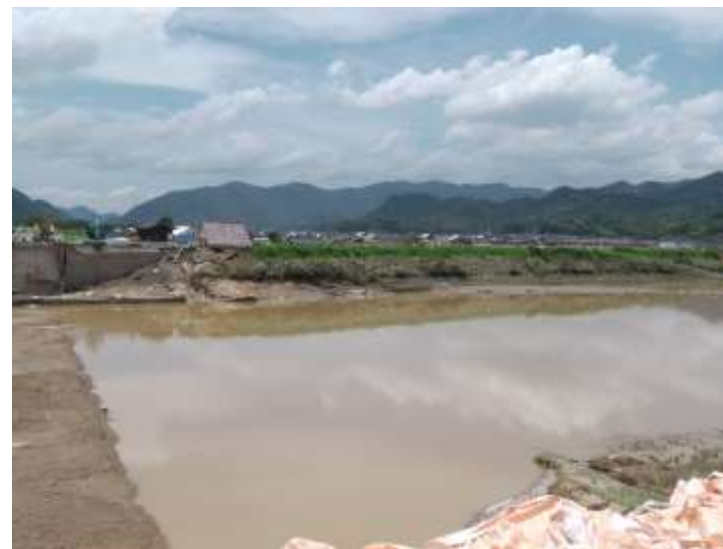
破堤箇所堤内地の状況
