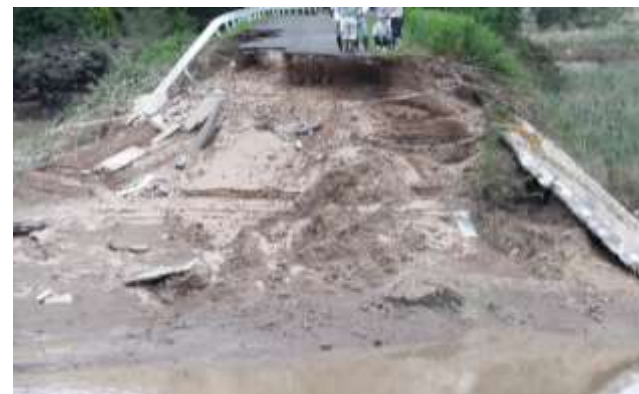
堤防破断面の状況
