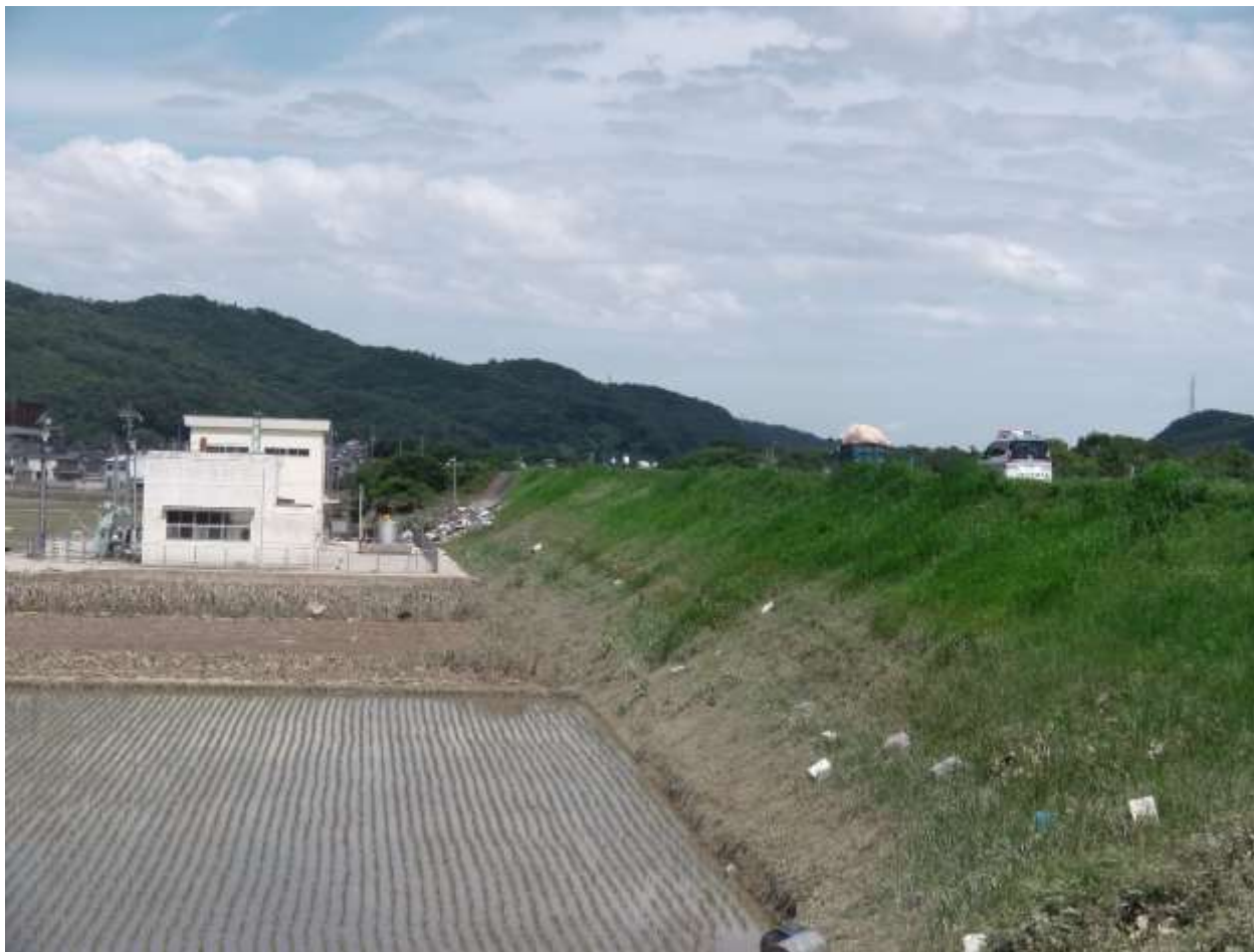
法面に浸水した後が残されている。水田面から約4m。
