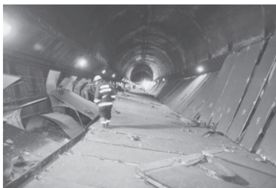
中央自動車道笹子トンネル上り線の事故現場。崩落した天井板などが見える＝3日午前2時10分【大月市消防本部提供】（2012年12月03日）【時事通信社】
