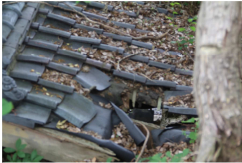
幸清水の壊れた屋根 (屋根は新たに作り直されました)
